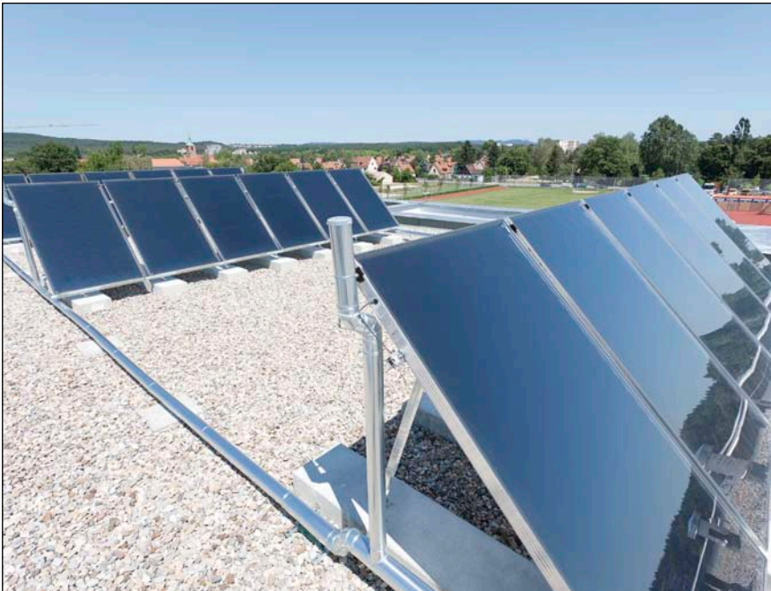
Bild 1: Stadtquartier Erlangen, Kollektoranlage auf dem Dach.
